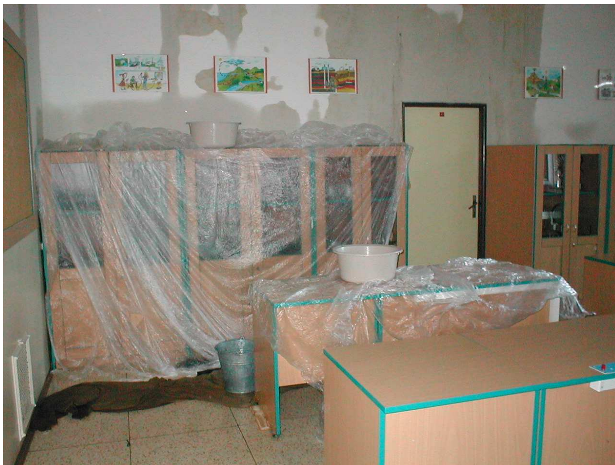
V učebně fyziky udělala voda největší škody na novém nábytku, elektrorozvodech, zdivu a také pomůckách.
